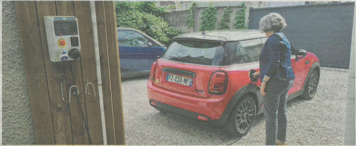
Valérie et Florian ont opté pour la borne à domicile qui a été installée par un électricien corrézien - © DR
